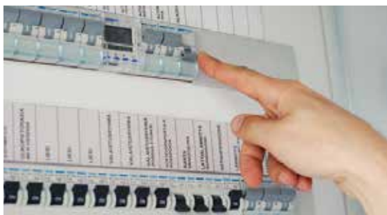
Kiinteästi asennettavan automaattisulakkeen asettaminen toimintakuntoon.
